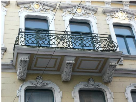
Beispiel erhaltenswerter historischer Balkone.
